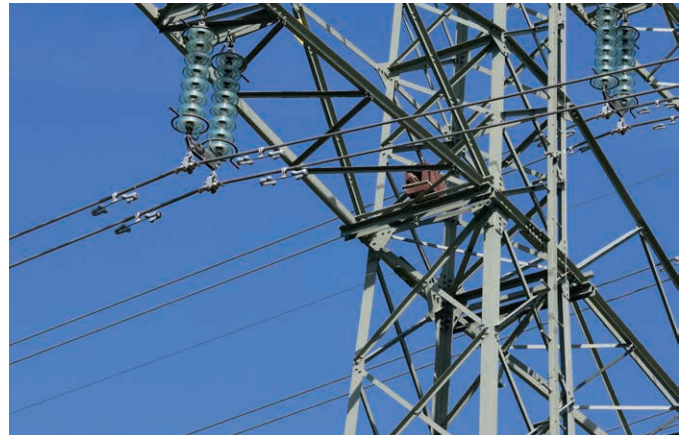
Turmfalkenkasten im Strommast (Schenefeld/PI , 01.05.2025, B. Eisenhardt)
