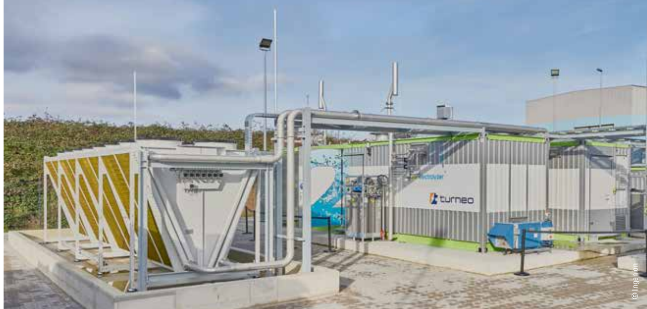
2MW-PEM-Elektrolyse der Turneo GmbH in Cuxhaven.
