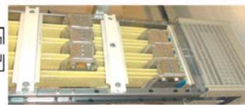
Anordnung: PE - L1 - L2 - L3 - N - L1 - L2 - L3 - N - L1 - L2 - L3 - N - PE
