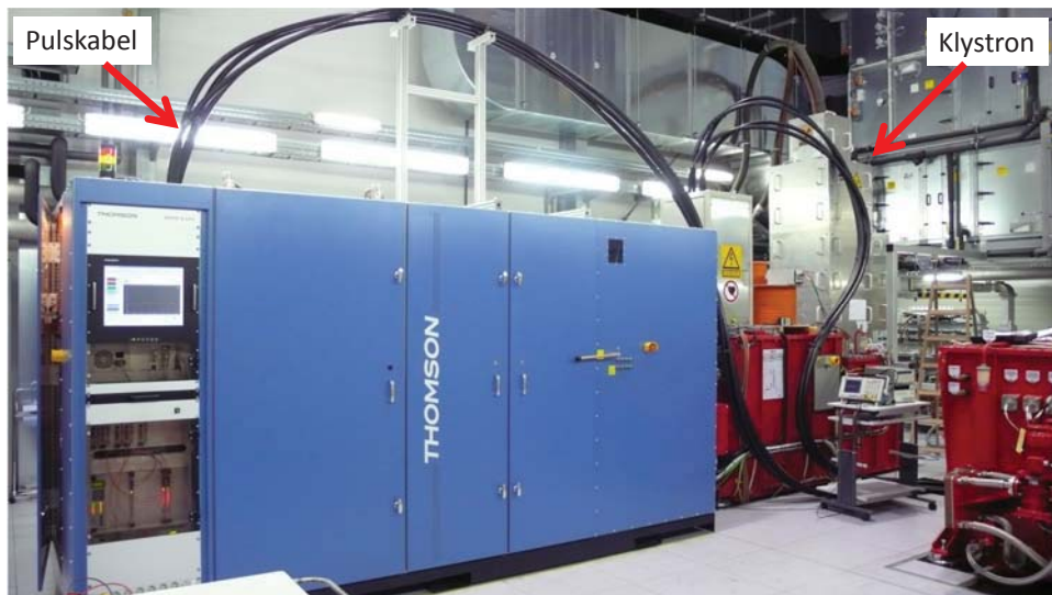
RF-Station mit Thomson Modulator und 5MW Klystron
