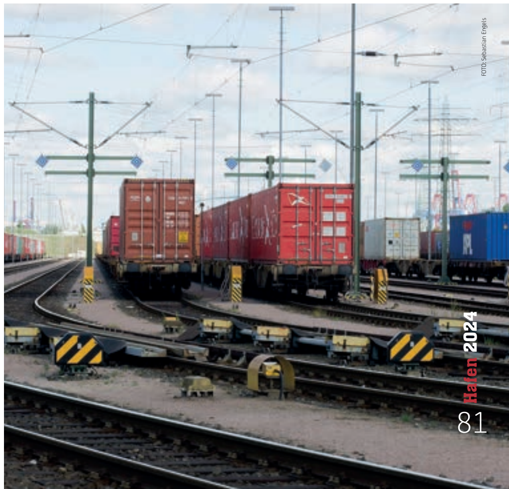
Die Hamburger Hafenbahn unterhält rund 300 km Gleisanlagen.
