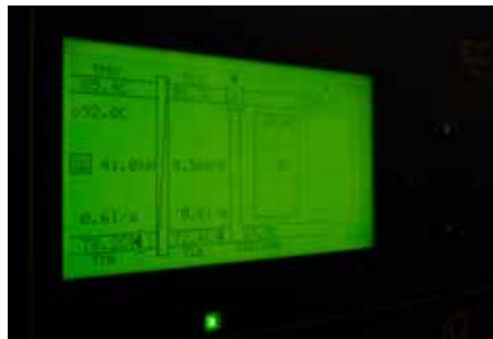
Stromerzeugung und die Heizleistung sind direkt abzulesen
