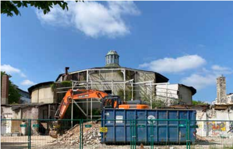
Vor drei Jahren wurden die Randgebäude der Schiller-Oper abgerissen. Sie standen nicht unter Denkmalschutz Foto © MM
