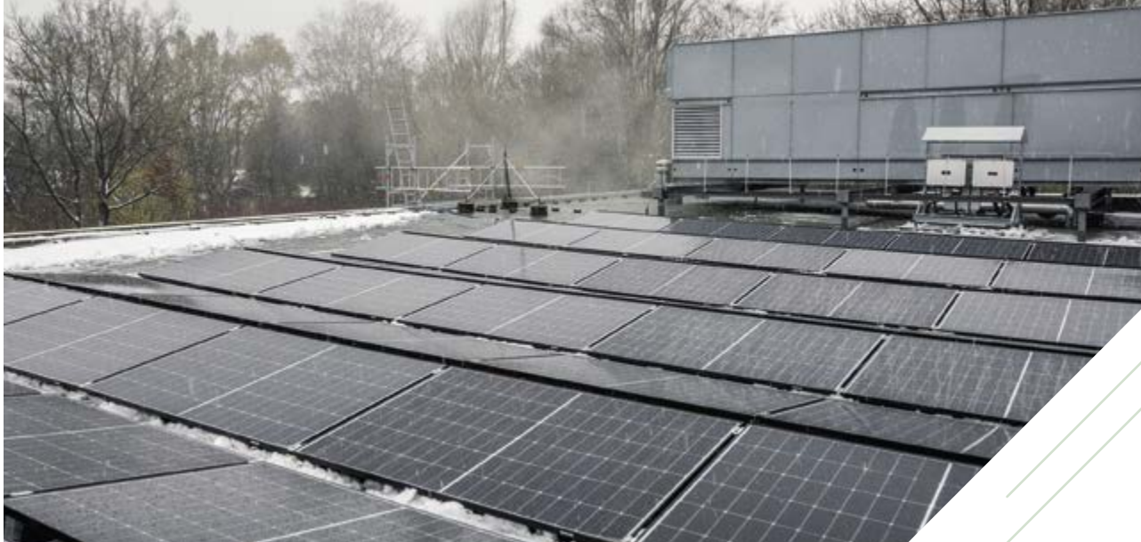
Photovoltaik-Anlage auf dem Dach des Bäderland Bramfeld
