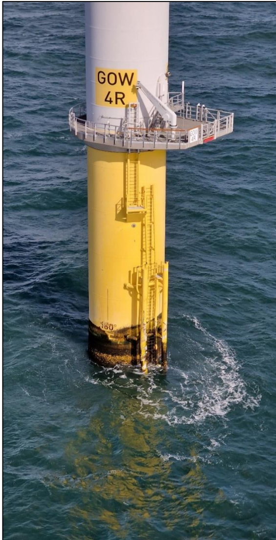
Abbildung 8: Der Sockel der angefahrenen WEA 14
