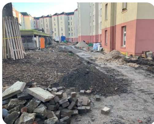
Die Sielsanierung (hier: Innenhof des Haubachblocks) bedeutet für die Bewohnerinnen und Bewohner eine strapaziöse Zeit.
