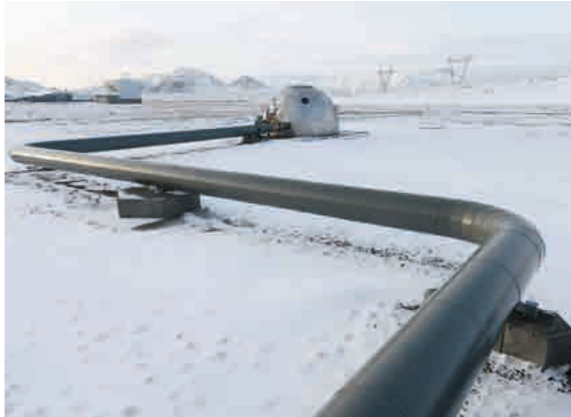
8.20 > Diese Rohrleitung gehört zum isländischen Projekt „CarbFix“. Dort wird seit dem Jahr 2014 abgeschiedenes und in Wasser gelöstes Kohlendioxid in die obere Ozeankruste injiziert.
