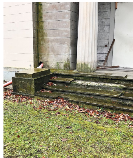
Feuchtigkeit und Moosbildung auf der großen Treppe
