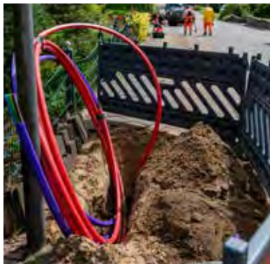
An vielen Ecken von Buxtehude und den umliegenden Orten werden derzeit solche bunten Glasfaserstränge verlegt, teils eben mit Hilfe von speziellen „Bodenraketen“.
