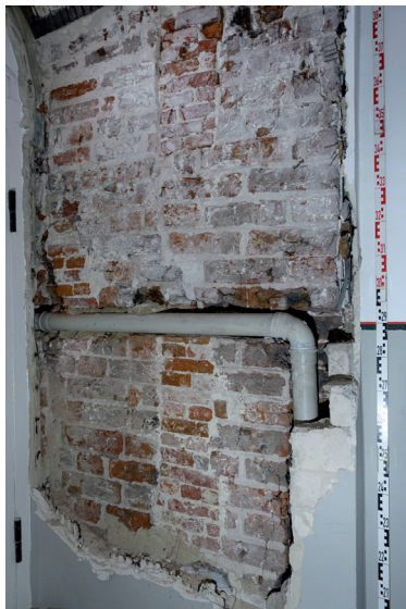
Abb. 53: Südliche Laibung der bauzeitlichen Ladeluke (um 1380) mittig in der Ostwand auf Ebene 4. Gleichmäßiger Verband mit Resten einer Fugenritzung.
