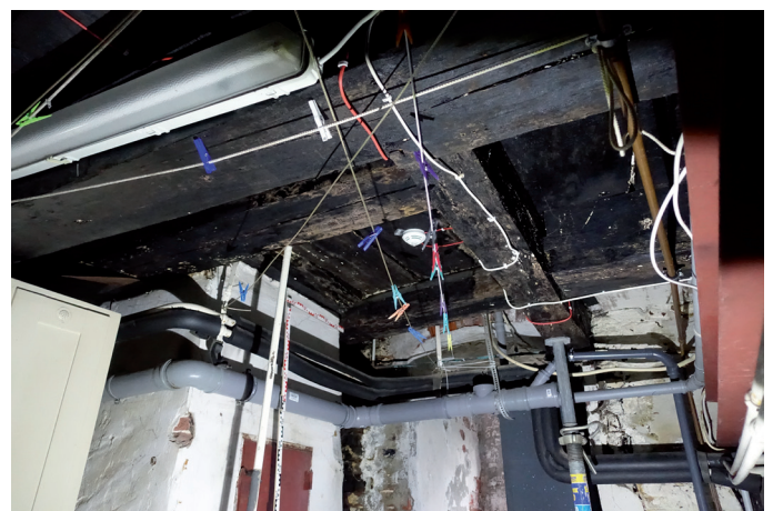
Abb. 43: Deckenbereich in ZG2.04 (Zwischengeschoss Ebene 2), Blick nach Südosten. Die bauzeitliche Deckenlage zeigt einen Wechselbalken zur Durchführung des mittelalterlichen Schornsteins. Aufnahme Frühjahr 2022.
