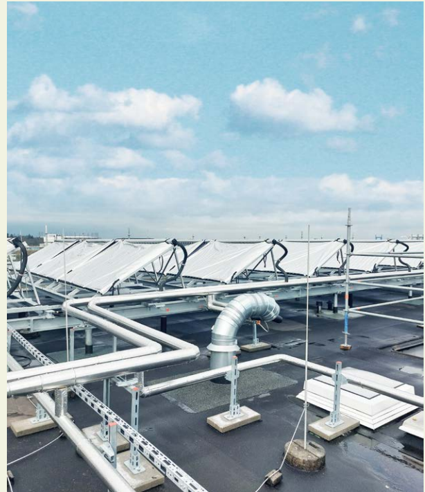
Thermische Solaranlagen der HanseWerk Natur auf dem Dach im Försterweg 92
