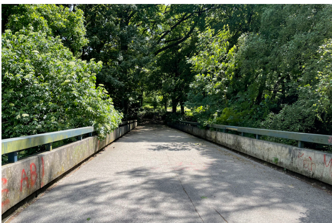
Bestand: nicht barrierefrei, verschatteter Zugang, wenig frequentiert und mit Graffiti verschmutzt
