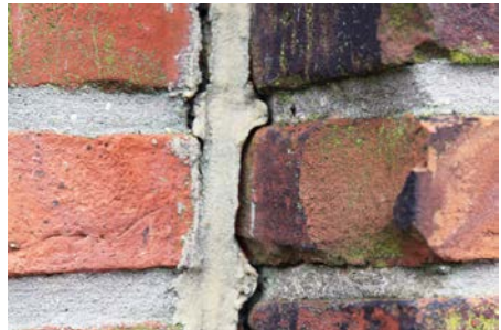
Falsch ausgeführte Dehnfuge
