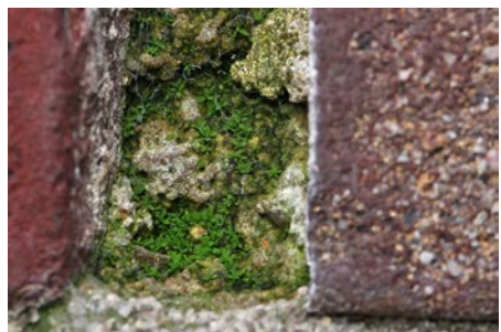
Bewuchs in ausgebrochener Fuge
