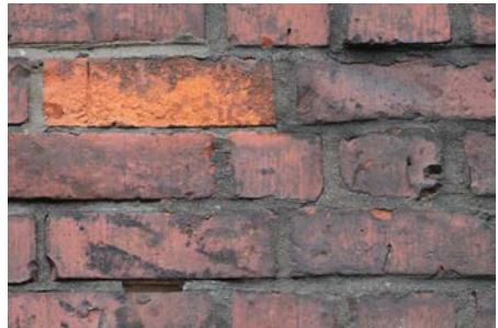
Schäden durch Hydrophobierung
