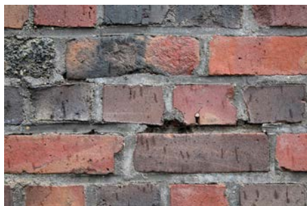
Zersetzungen und Ausbrüche
