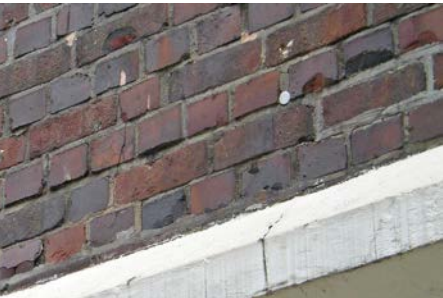
Abscherbelungen im Anschluss an das Gesims
