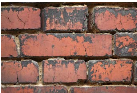
Mörtelabtragung durch Mauerwespen
