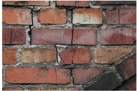
Risse durch Stein und Mauerwerk
