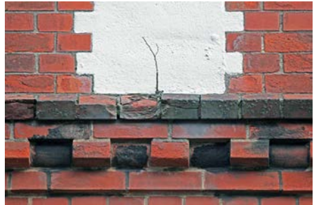
Abplatzungen am Gesims
