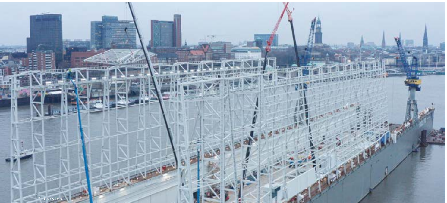
Überdachung: Das Dock 10 von B+V wird für den nächsten Einsatz vorbereitet
