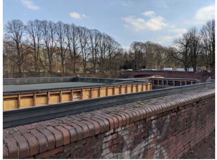
ÜBER DIE BRÜSTUNGMAUER AUFRAGENDE GASTRONOMIEEINBAUTEN AM KANAL
