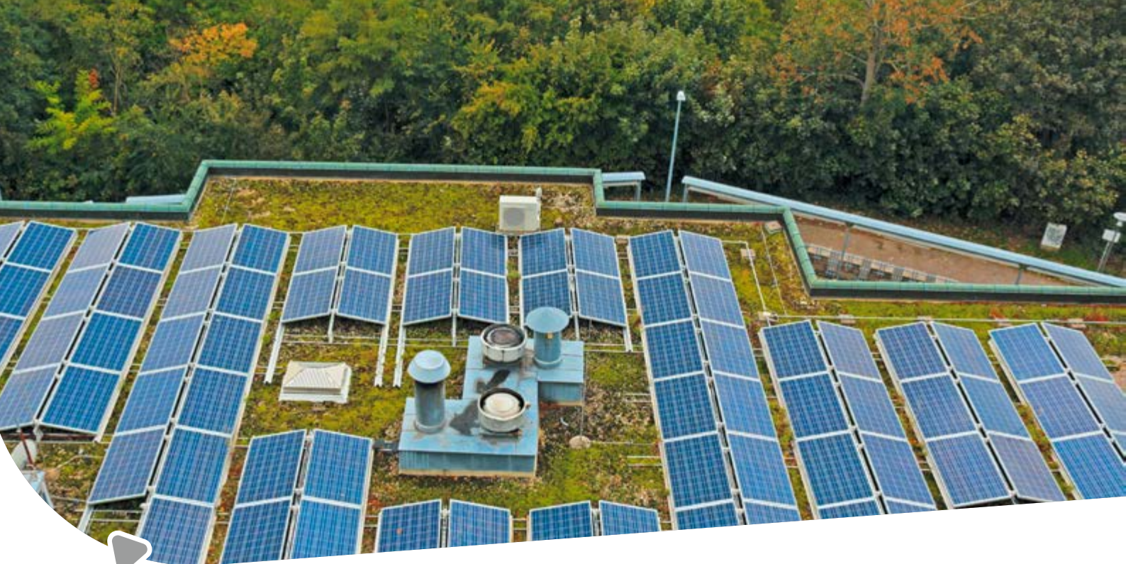
Gründach mit Photovoltaik-Anlage
