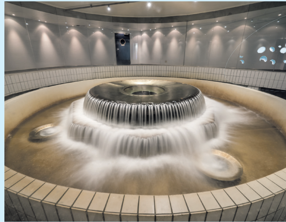
Vom Rohwasser zum Trinkwasser – hier ein Bild aus dem Wasserwerk Walddörfer. Foto: Hamburg Wasser
