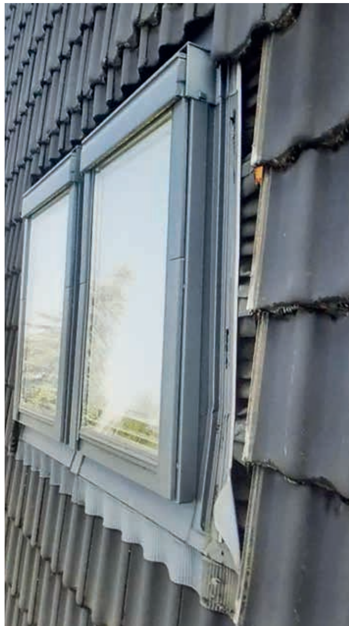
Wirbelschlepppe – Vier fehlende Steine beim Fenster
