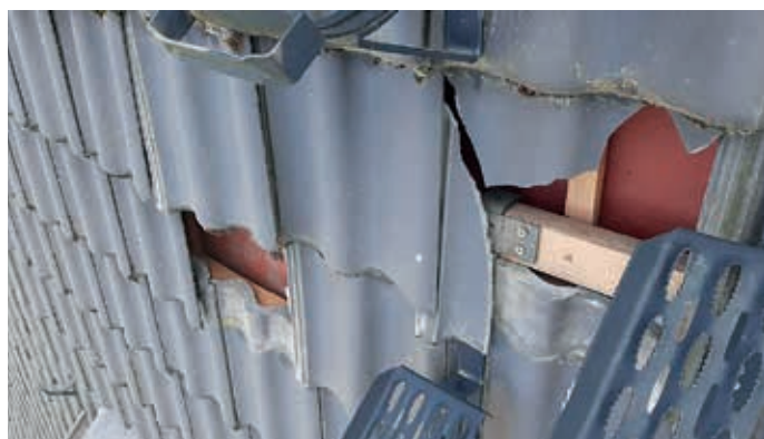
Wirbelschlepppe – Löcher im Dach
