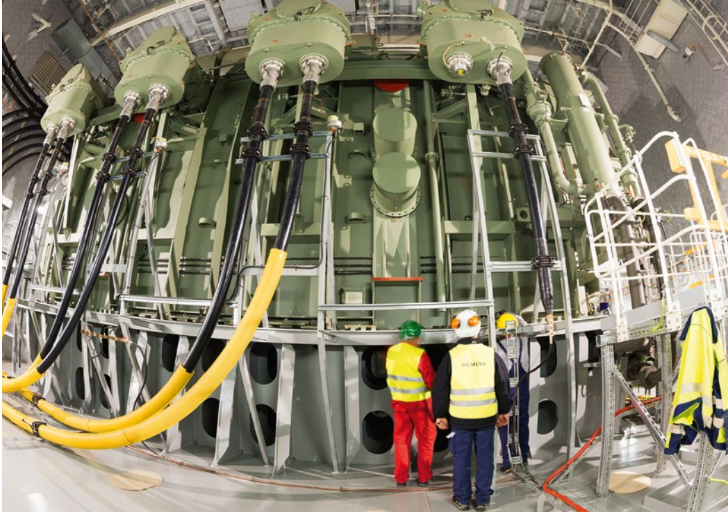
GIGANTEN. Zwei Maschinen- Transformatoren stehen auf der SylWin1-Offshore- Plattform. Gewicht: je 490 Tonnen.
