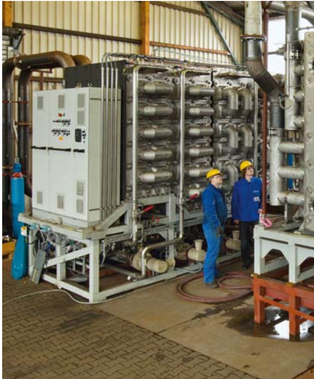
Effizienz: Absorptionskälteanlage zur optimalen Nutzung der thermischen Energie
