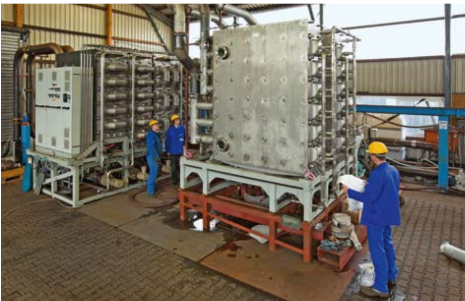
Schiffstauglich: Die thermische Energie wird zuerst für die Absorptionskälteanlage und später für die Produktion von Frischwasser genutzt.
