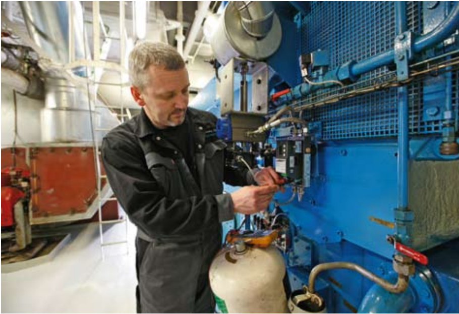
Kontrolle: Messungen am SCR-System während der Testphase
