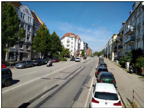
Abbildung 4: schlechter Fahrbahnzustand Lokstedter Weg (Nord) (Quelle: IVAS)
