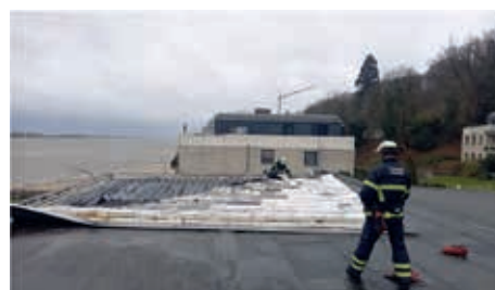
Eine Dachhaut, die sich verselbständigt hat
