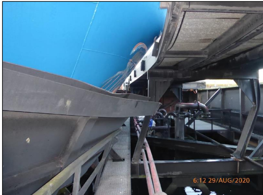
Abbildung 7: Beschädigung Schleusentor (Detailaufnahme 1) 23
