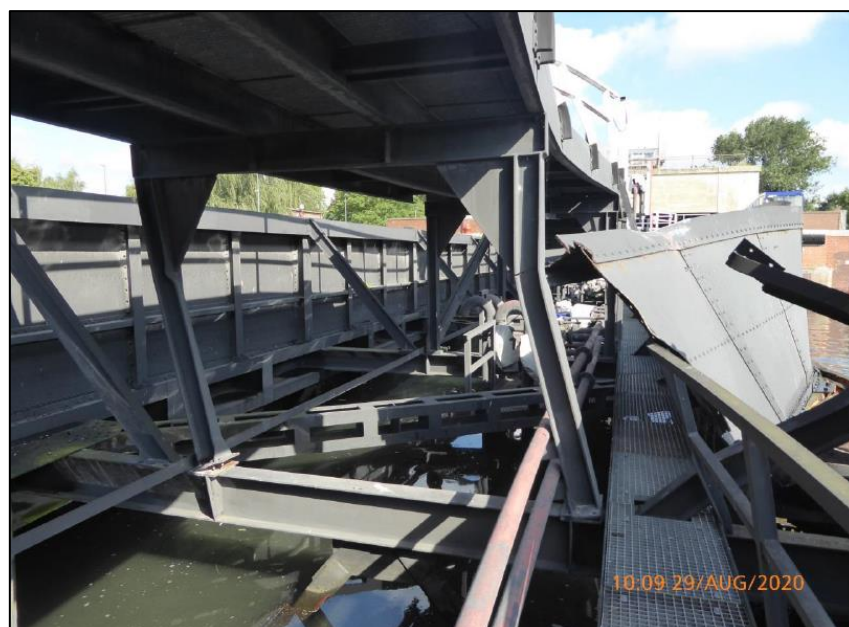
Abbildung 8: Beschädigung Schleusentor (Detailaufnahme 2)
