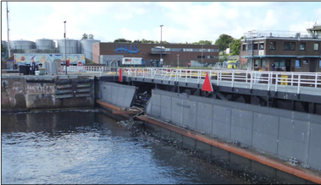
Abbildung 9: Beschädigung Schleusentor (Gesamtansicht) 24
