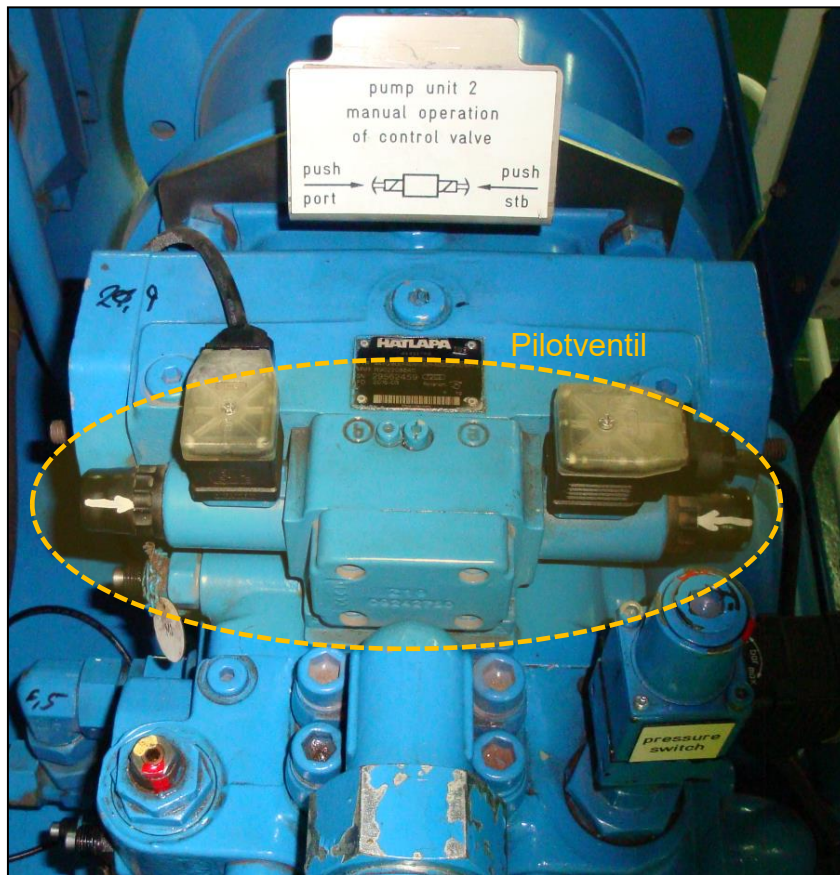
Abbildung 10: Pilotventil von Ruderpumpe 2, inkl. Kurzanleitung für die Notsteuerung
