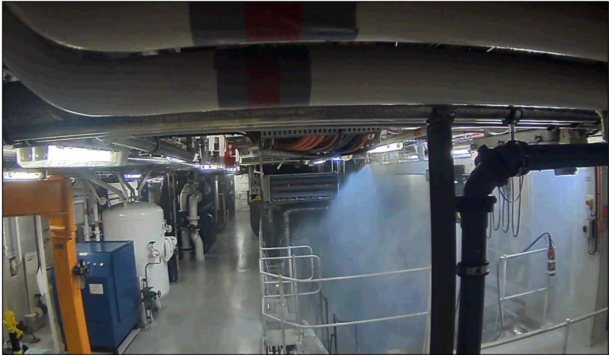
Abbildung 5: Ausgelöstes Objektschutzsystem über HM 3 10
