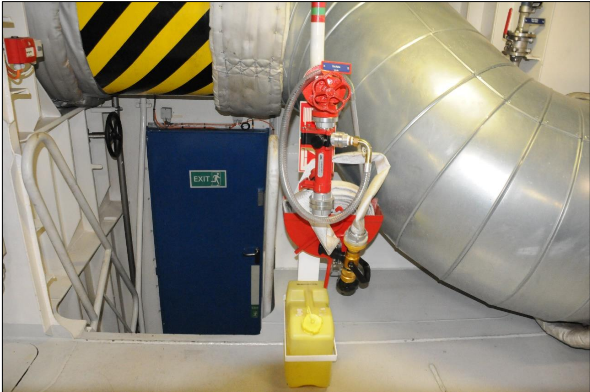
Abbildung 46: Hydranten-Station mit Schaum-/Netzmittelzumischung
