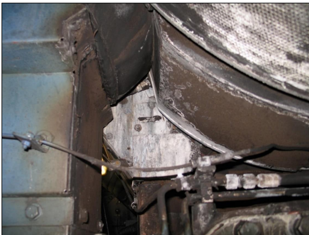
Abbildung 20: Brandschaden an der Abgasisolierung am Turbolader (Luftseite)
