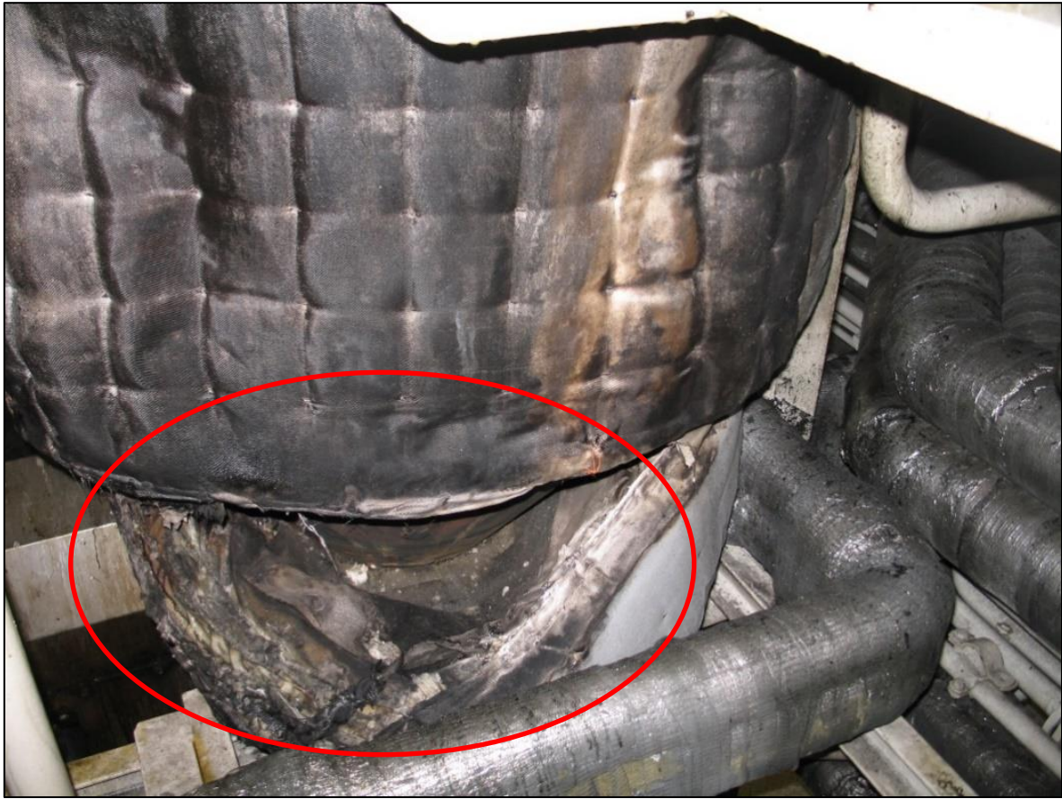
Abbildung 18: Brandspuren an den Isoliermatten der Abgasleitung
