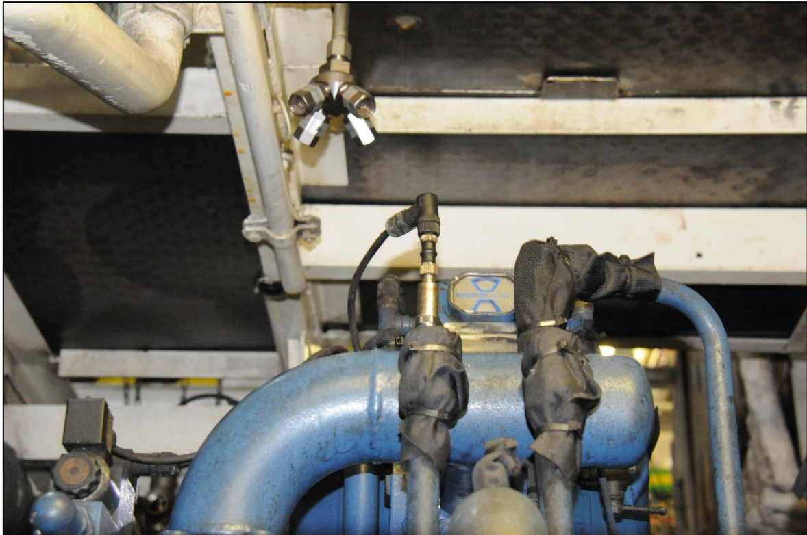
Abbildung 47: Drucksensor ersetzt Manometer am Getriebe
