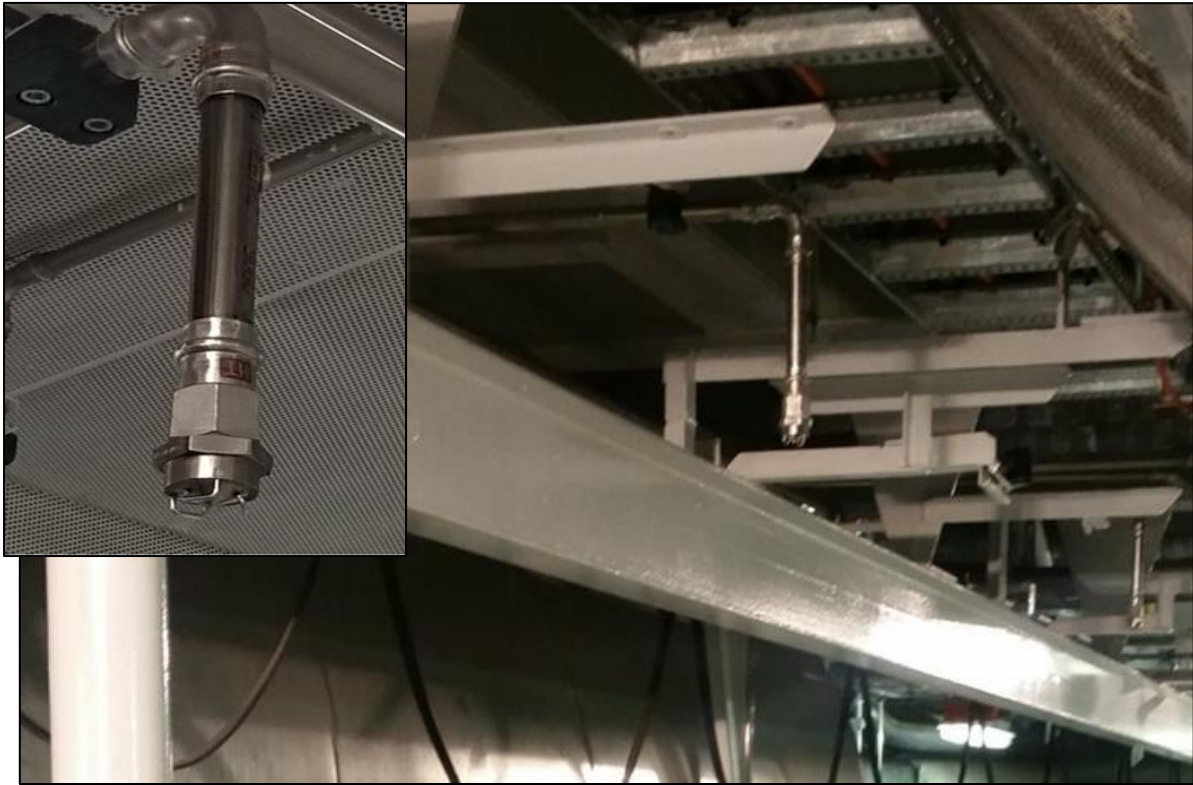
Abbildung 29: Objektschutz über der Maschine
