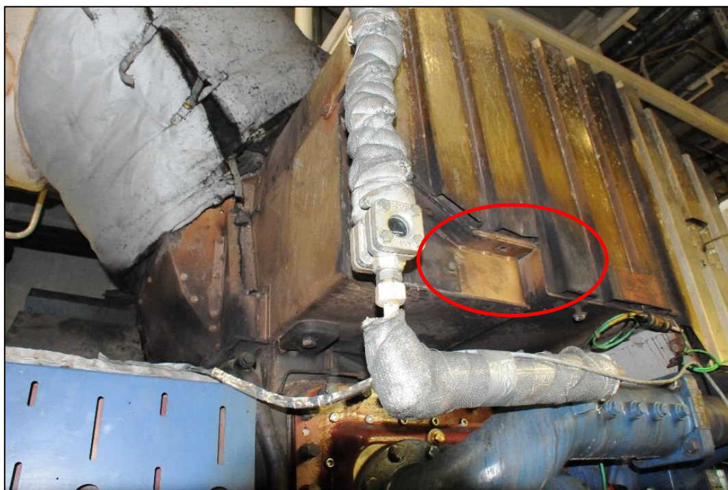
Abbildung 24: Brandspuren an der Außenseite des Turboladers (Abgasseite)
