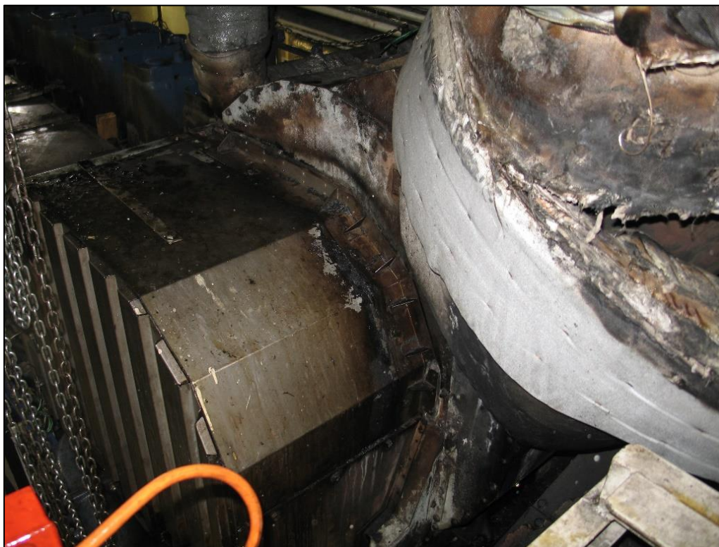
Abbildung 22: Brandschaden Abgasisolierung im Bereich des Turboladers
