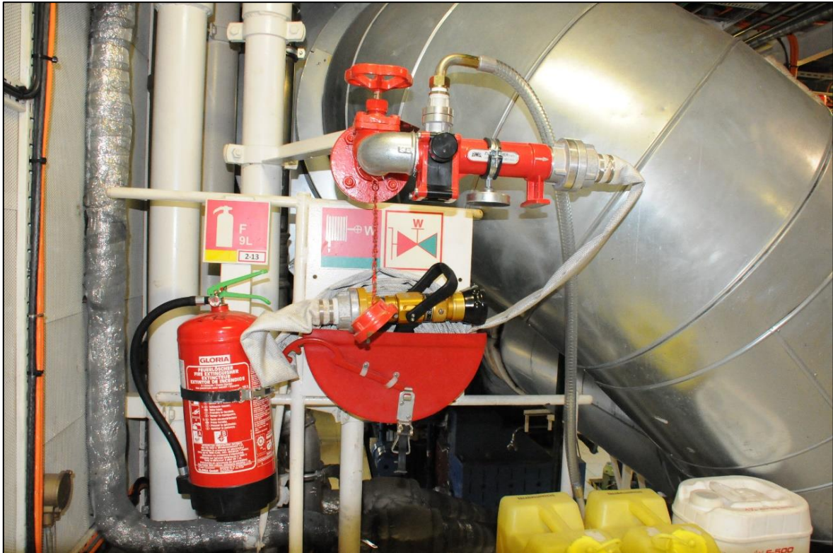
Abbildung 44: Hydranten-Station (Risiko-Bereich) mit festinstallierter Zumischung und Turbo-Strahlrohr
