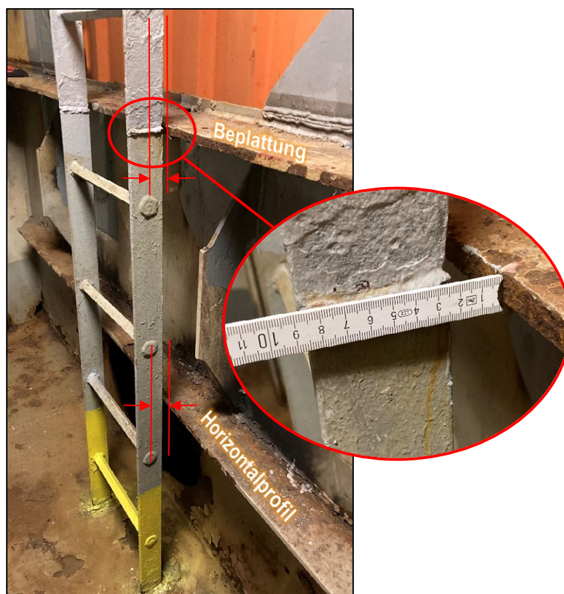
Abbildung 14: Geringer Abstand hinter der Laderaumleiter 56
