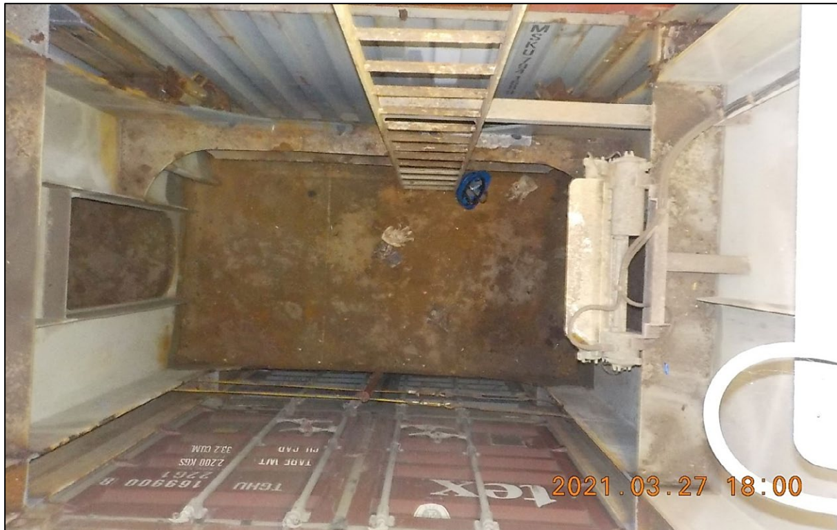
Abbildung 5: Blick von oben auf das 4. Stringer Deck in Laderaum Nr. 3, Unfallort 15
