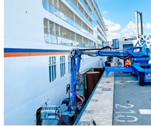
Landstromanlage in Hamburg.
