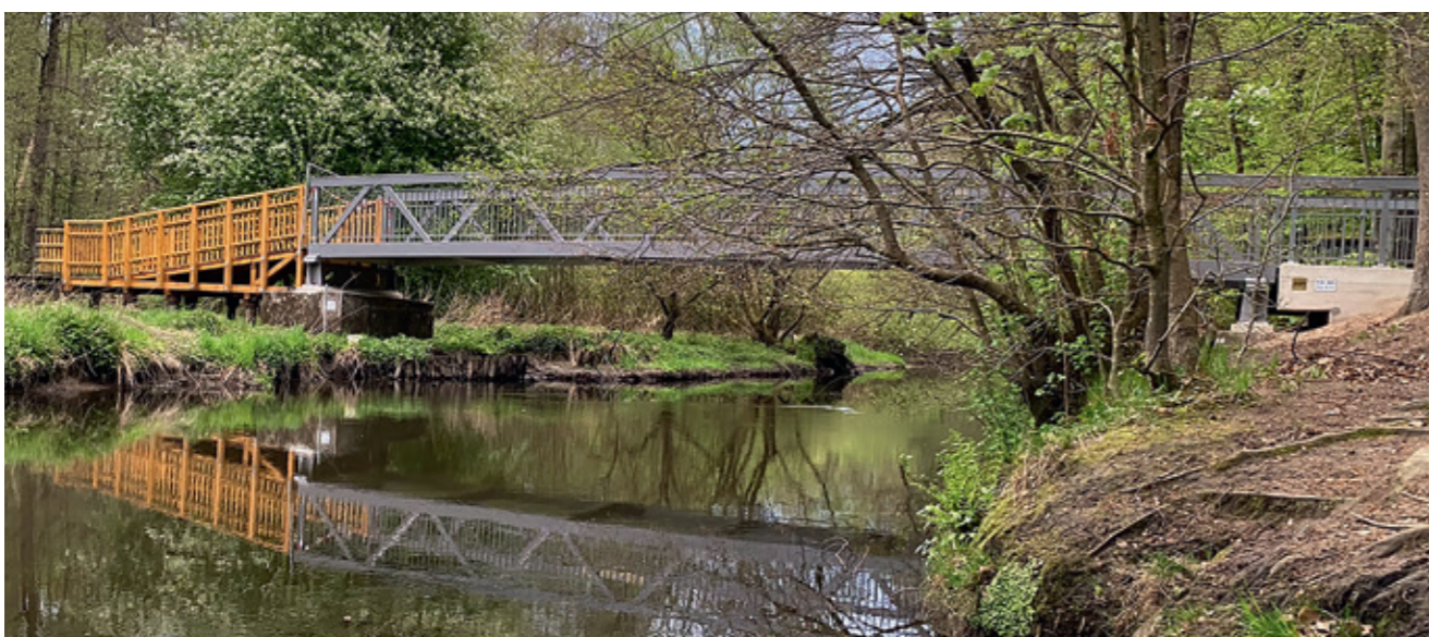
Die Pionierbrücke ist eine wichtige Verbindung zwischen Bergedorf und Reinbek. Oben: Die Brücke vor der Sanierung; unten: die neue Konstruktion.
