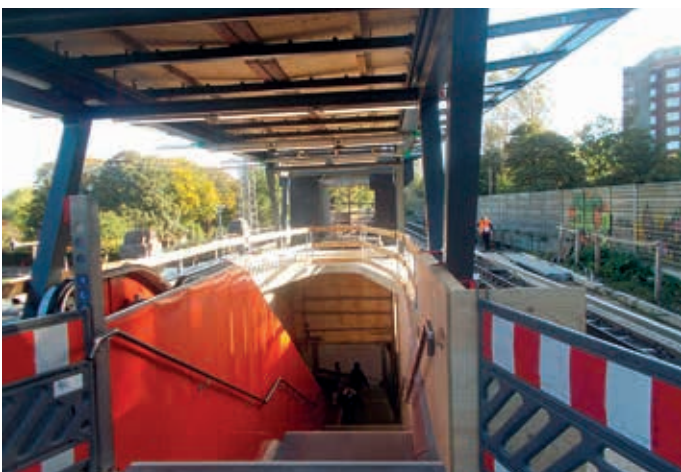
Die Fußgängerebene vor dem oberen Aufzugausgang (noch mit einem Holzzaun gesichert). Links die neue Rolltreppe.
