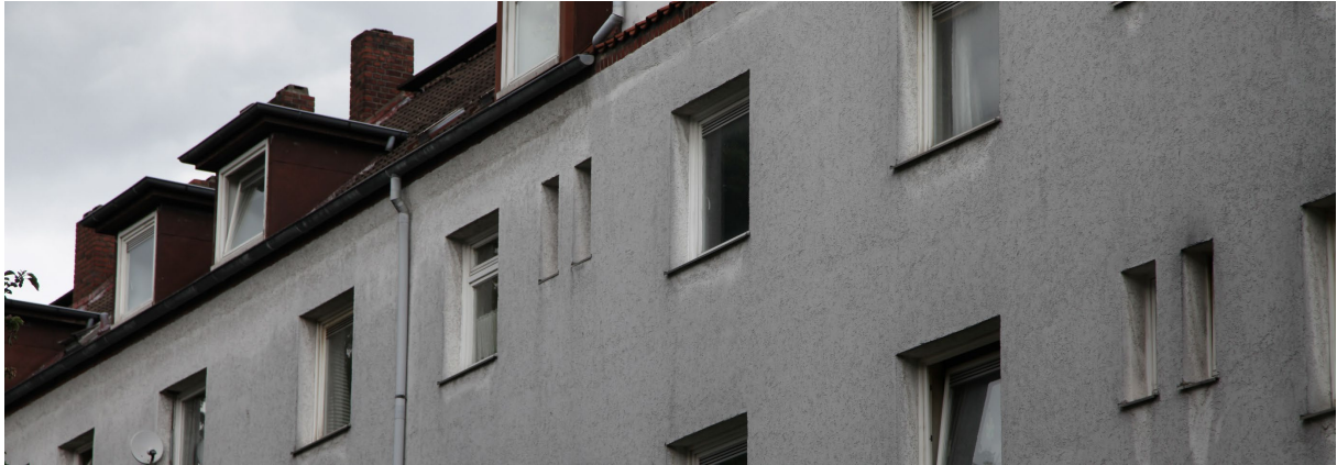
Abb. 4 Vergrauung und Schmutzschlieren auf Außenhaut einer gedämmten Putzfassade
