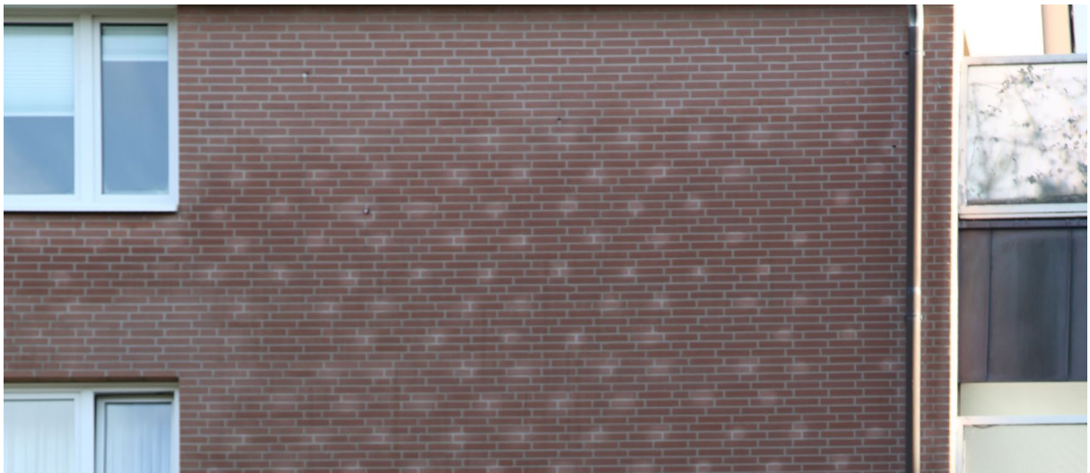
Abb. 5 Wärmebrücken über ungedämmten Fassadenankern
