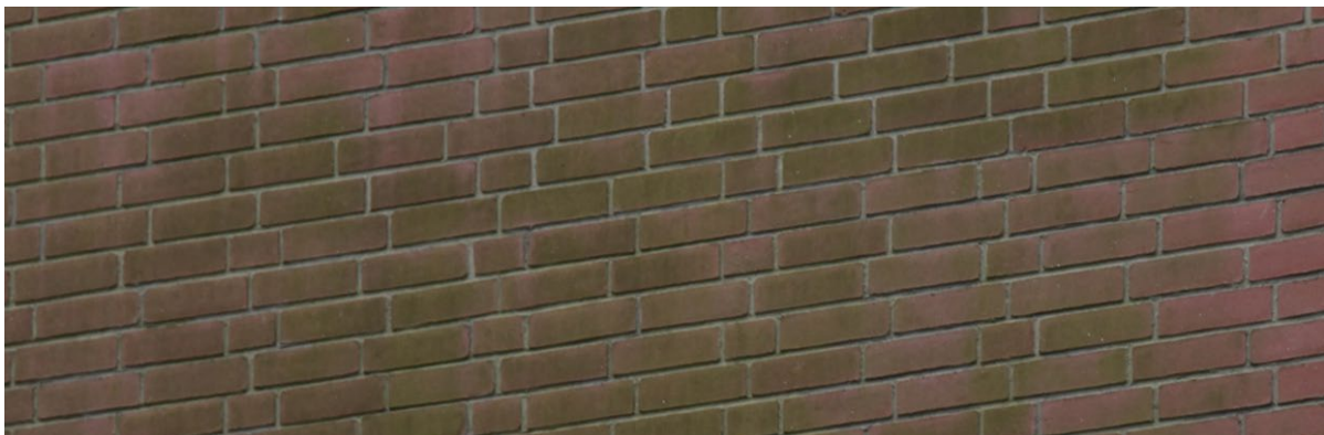
Abb. 3 Algenbildung durch beständigen Feuchtigkeitsfilm auf dem Fassadenfinish
