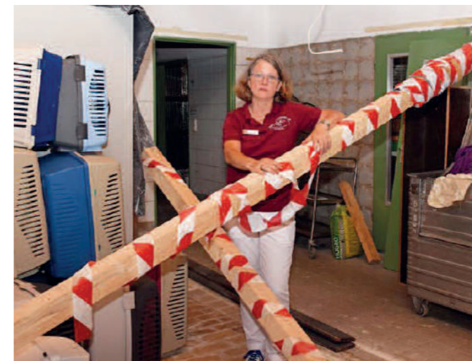
Unsere tierärztliche Leiterin Dr. Urte Inkmann im baufälligen Alten Katzenhaus – dicke Balken stützen die einsturzgefährdeten Wände ab.
