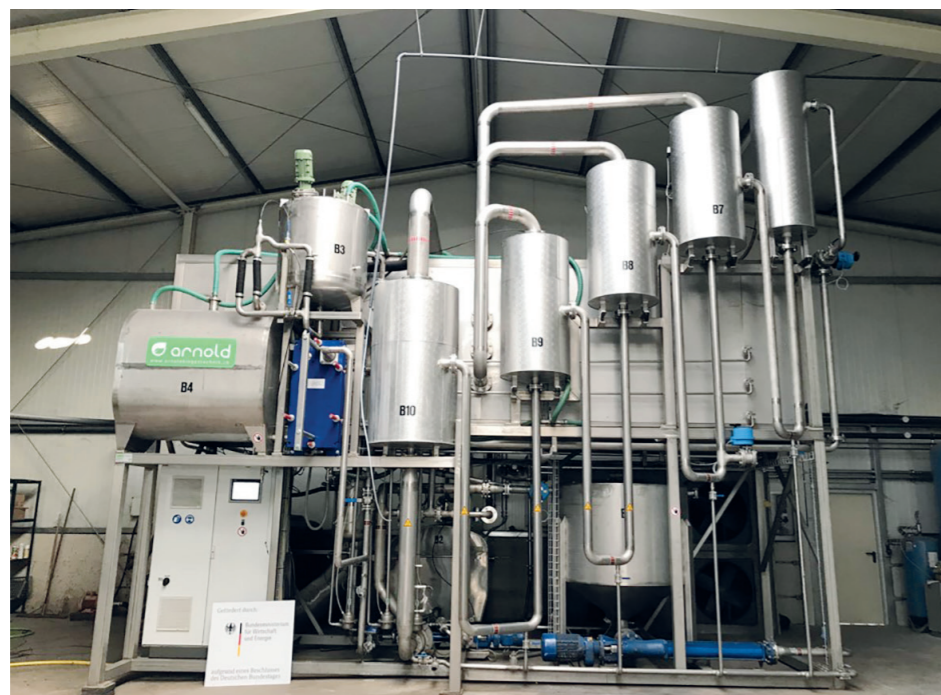
Abbildung 2: Verdampferanlage (Quelle: Rückert NatUrgas GmbH)
