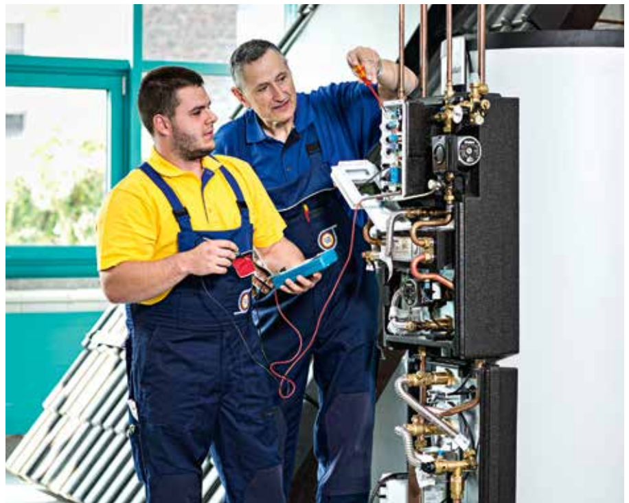
Solarthermie, Speicher und Heizsystem. Ein wichtiges Zusammenspiel zeitgemäßer energieeffizienter Komponenten.
