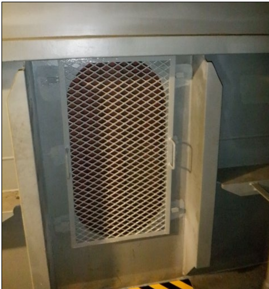
Abbildung 26: Abgesicherter Zugang zum Laderaum mit Absturzgefahr 78
