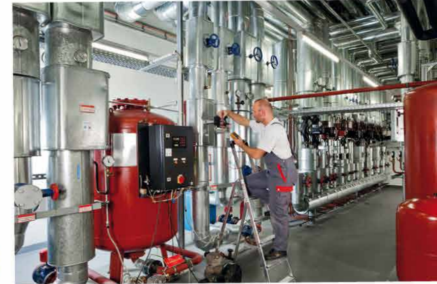
Arbeitsalltag eines Servicetechnikers (Elmatic-Heizzentrale 9031)
