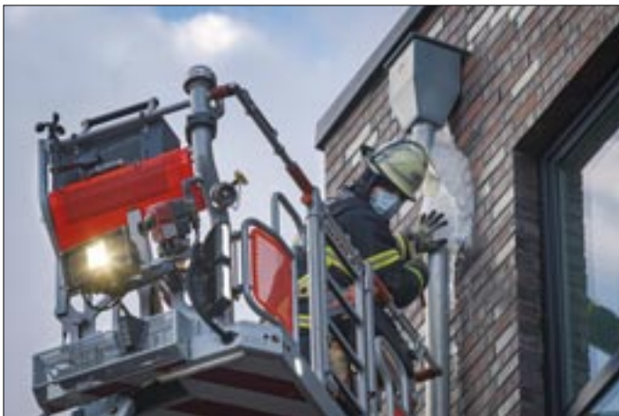
12.02.2021, DRZF, ALTONA: In den wenigen, sehr kalten Wintertagen wetterbedingte Einsätze der Feuerwehr. So drohen große, schwere Eiszapfen von einer Regenrinne auf Fußweg und Autos zu stürzen. Die Kollegen der Feuerwache Altona entfernten diese mithilfe der Drehleiter
