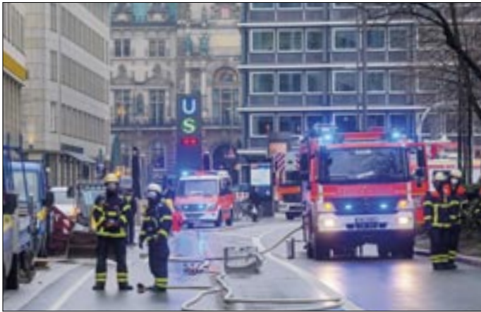
11.01.2021, THE, ALTSTADT: Gasleitung durch Stemmarbeiten beschädigt, Absperrung der Einsatzstelle, Sicherstellung Brandschutz mit einem C-Rohr. Abdichtung der Schadstelle durch Gasnetz Hamburg, Übergabe der Einsatzstelle an eine Gerüstbaufirma
