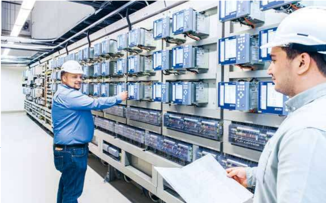
Projektleiter Tim Klotz und Kazim Görgüc an den neuen Schutzgeräten des modernisierten UW St. Georg
