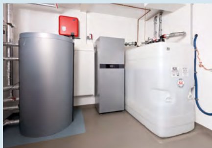
Mit einer Hybridheizung und alternativen Brennstoffen können auch ölbeheizte Gebäude die Klimaziele erreichen.
