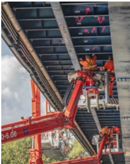
Bauwerksprüfer im Einsatz (in 55 Meter Höhe) Alle gefundenen Schäden und Schadensverdachtspunkte werden markiert und dokumentiert
