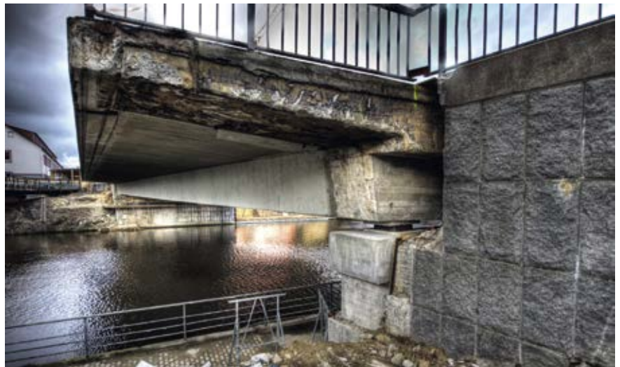
Nach Süden verschobener Überbau
