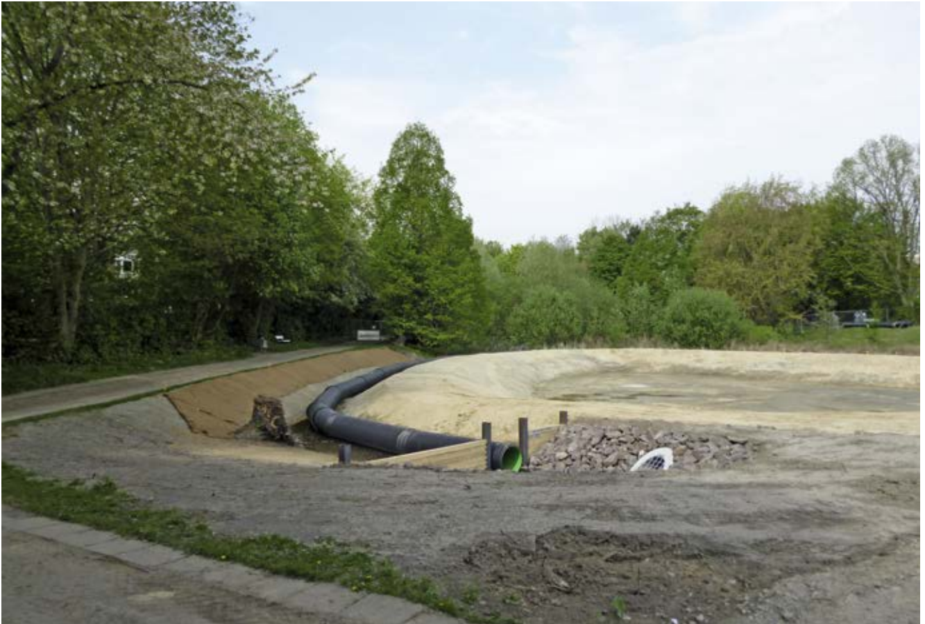
Rückhaltebecken nach Entschlammung und Trennung Bornmühlenbach/Biotop
