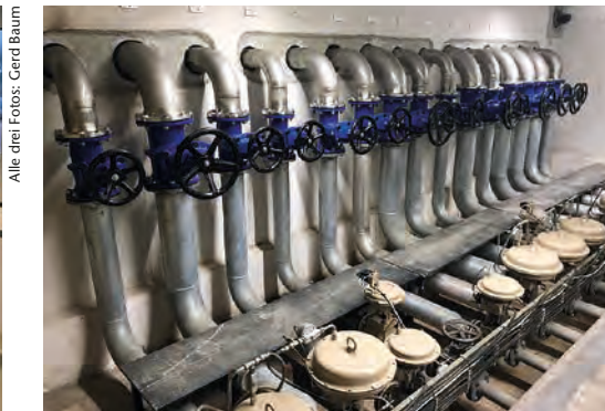
Das Herz der Anlage – die Pumpenkammer
