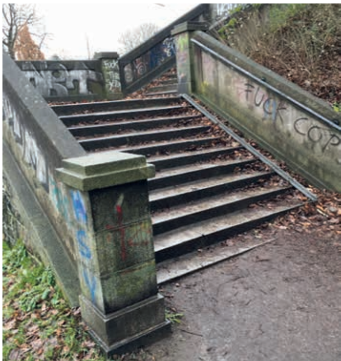
Eine der mit Graffiti verschmierten Treppen Foto: Prott
