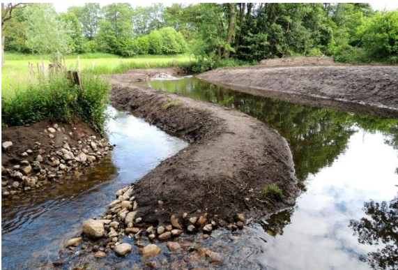
Sandfang am „Weg zum Brook“ (Foto: Sönke Meyer)
