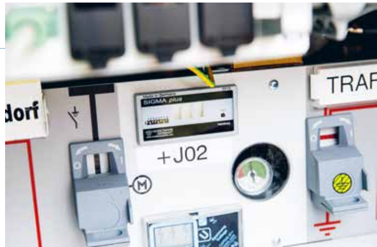
Frontansicht der MS-Schaltanlage in einer ferngesteuerten Netzstation
